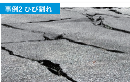
事例2 ひび割れ
